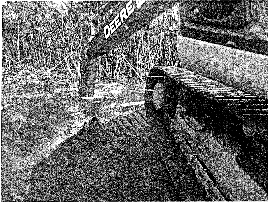
Foto 19 – Vista do solo 100% saturado no local onde passará o caminho de serviço
