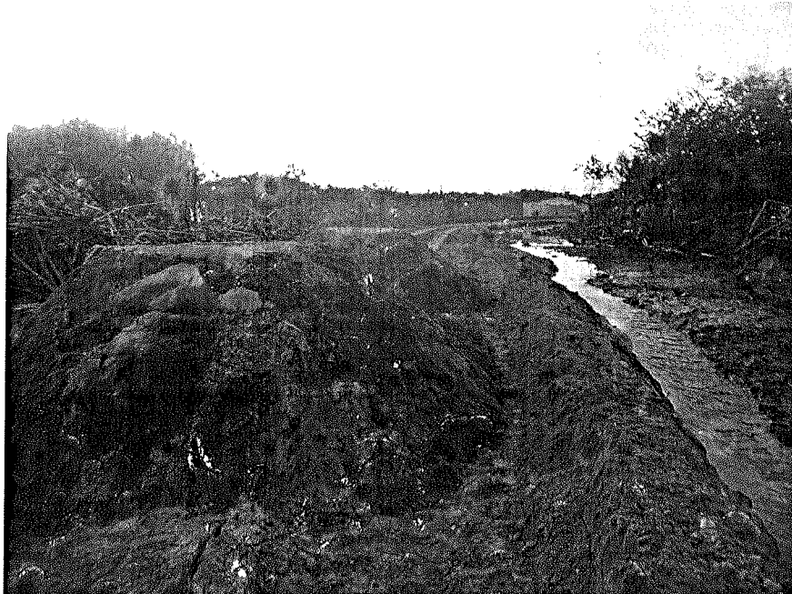
Foto 23 – Tem trechos, que mesmo após o caminho de serviço concluído, com o tráfego pesado das máquinas e caminhões, e como a base tem muita lama, este aterro sofre cisalhamento (afunda), necessitando de mais material para restaurar a via.
