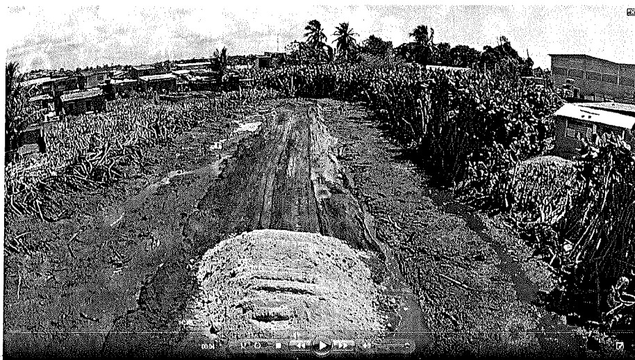
Foto 03 – Ver que o caminho de serviço é construído dentro da lama
